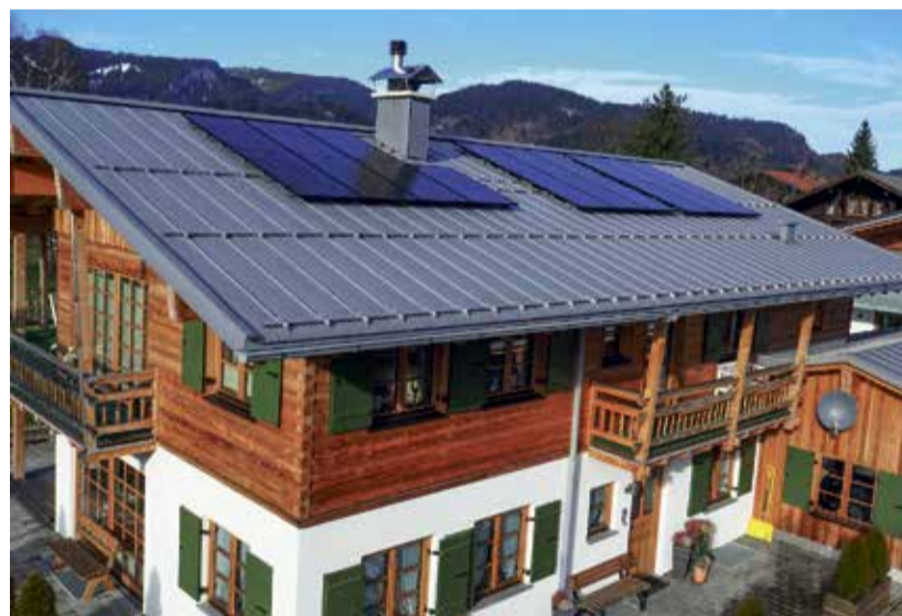
Schneefangsystem mit einer PV-Anlage auf einem Metaldach,
